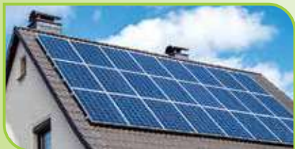
Мал. 121. Сонячні батареї на даху приватного будинку
